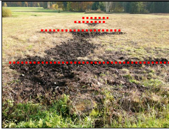
Abb. 26: Nach Abschluss der Phase 1 sind die Spundwände noch zu erkennen. Hier ist der Strang D dargestellt. 24.10.2005
