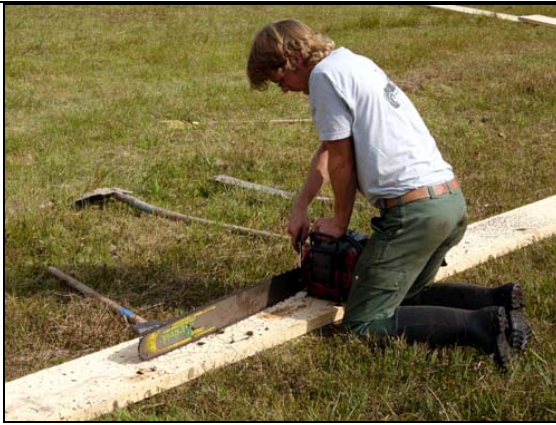
Abb. 8: Mit dieser Kettensäge mit langem Schwert und Chromstahlkette wurden die Spundwände vorgeschritten. Dabei ging es in erster Linie darum, das im Moor liegende Wurzelwerk der Bäume und Sträucher durchzutrennen, um eine Ablenkung der Spundwand-Bohlen zu verhindern. 15.09.2005
