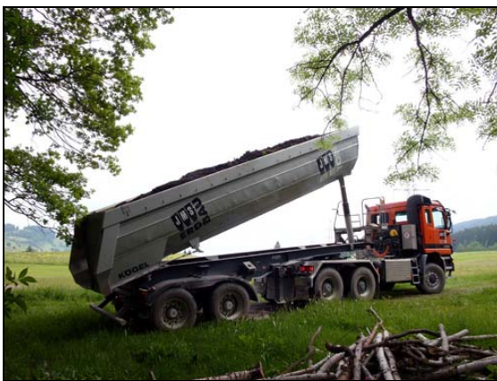
Abb. 5: Die mit den Spundwänden aufgestauten Entwässerungsgräben wurden mit Torf hinterfüllt. Der Torf wurde auf Vermittlung des ARE-SG, Natur- und Landschaftsschutz, vom Kanton Nidwalden zur Verfügung gestellt. Das Bild zeigt das Kippen des Torfes am Zwischendepot. 30.05.2005
