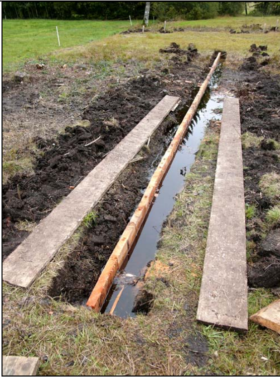
Abb. 22: Nach dem Setzen der Bohlen wurden sie mit der Kettensäge ins Lot geschnitten. Bereits staut sich bergseits das Wasser. Als nächstes wird Torf eingefüllt. 21.09.2005
